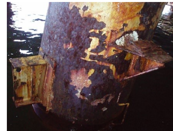
в). Разрушение покрытия в зоне забрызгивания. Срок эксплуатации 8 лет
