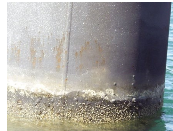
а). Разрушение покрытия в зоне переменного смачивания. Срок эксплуатации 1 год
